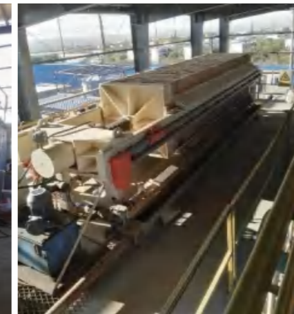
污泥脱水系统
