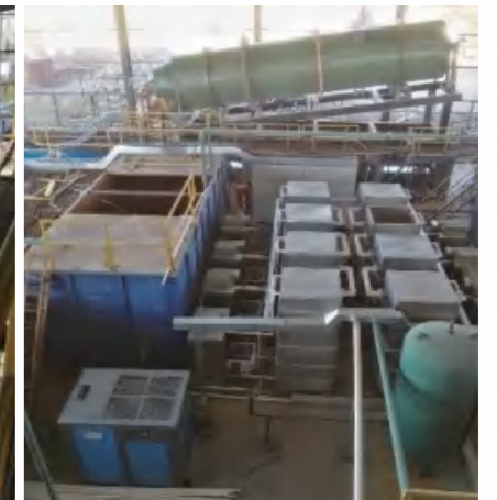
含油污水处理系统
